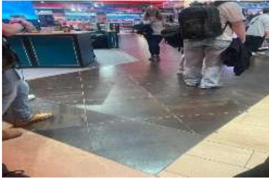
Figura 19. Cambio en el color de piso en la terminal uno del Aeropuerto Internacional de la Ciudad de México (Necesidades de seguridad)
